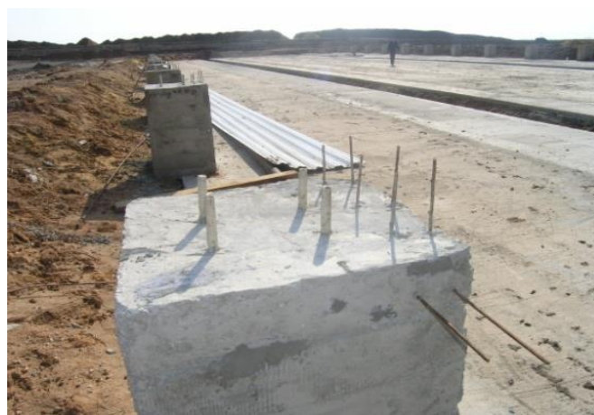
Рис. 2. Развитие трещин в фундаментах
