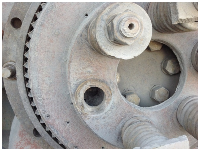
Рис. 10. Система предохранения от перегрузки в «неисправном» состоянии (оборван один болт, отсутствует одна пружина)
