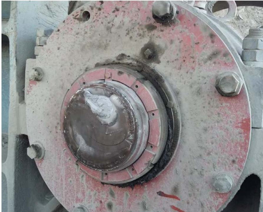
Рис. 2. Общий вид разрушения эксцентрикового вала
