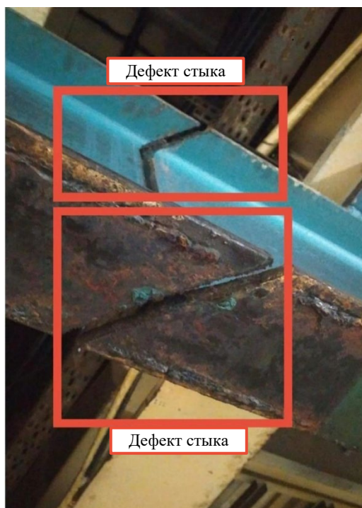
Рис. 10. Дефект в области теплового стыка двутавровой балки
